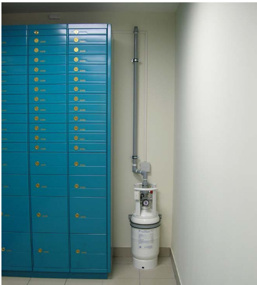
▲ Рис. 2. Помещение модульной АУГПТ дата-центра
